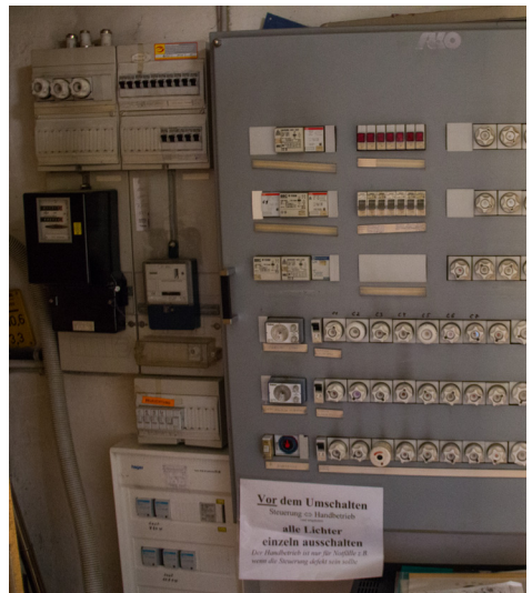
Elektroschaltkasten in der Kirche
